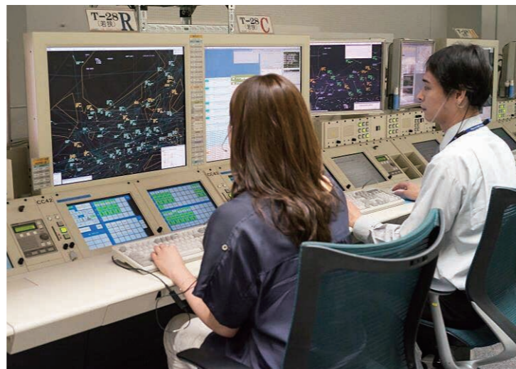
レーダ監視設備
