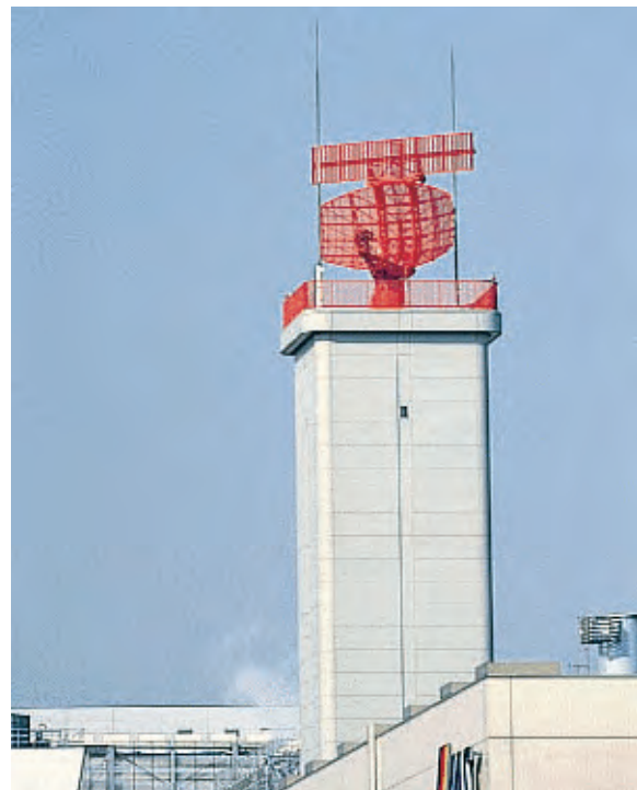
空港監視レーダー(ASR/SSR)
