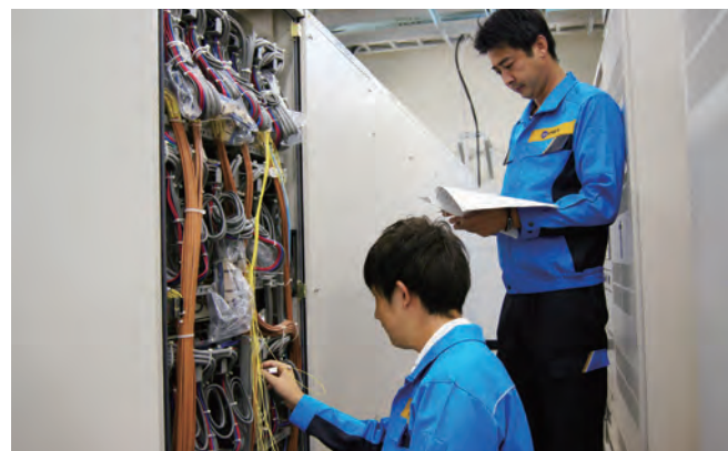
ネットワーク部 交換機の動作試験
