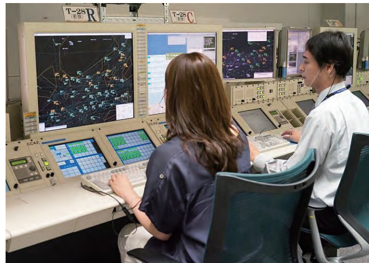
レーダ監視設備
