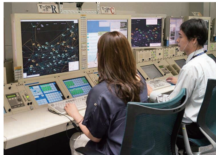
レーダ監視設備
