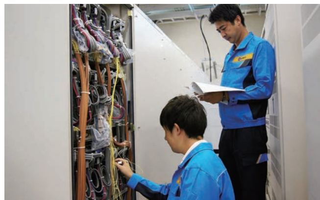
ネットワーク部 交換機の動作試験
