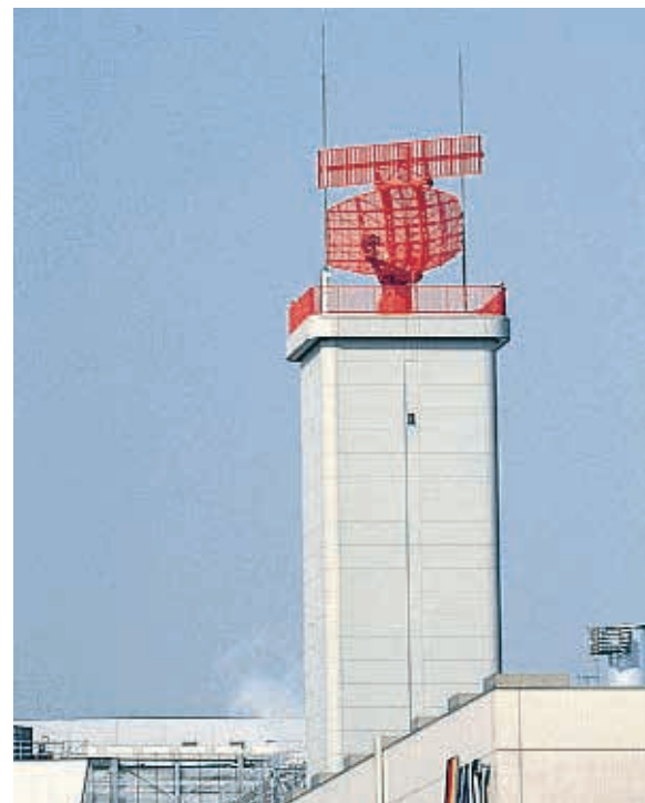
空港監視レーダー（ASR/SSR）
