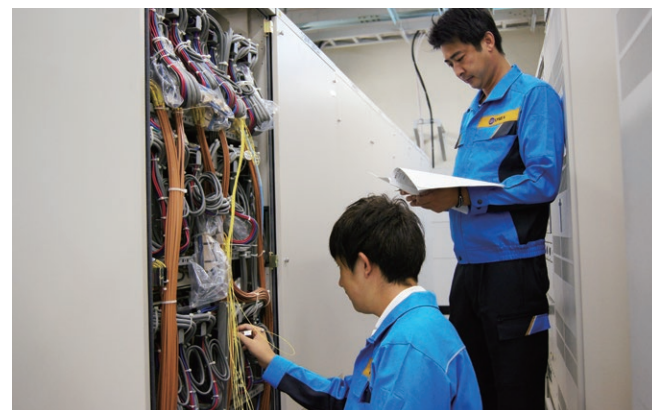
ネットワーク事業部 交換機の動作試験
