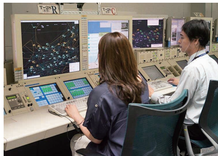
レーダ監視設備
