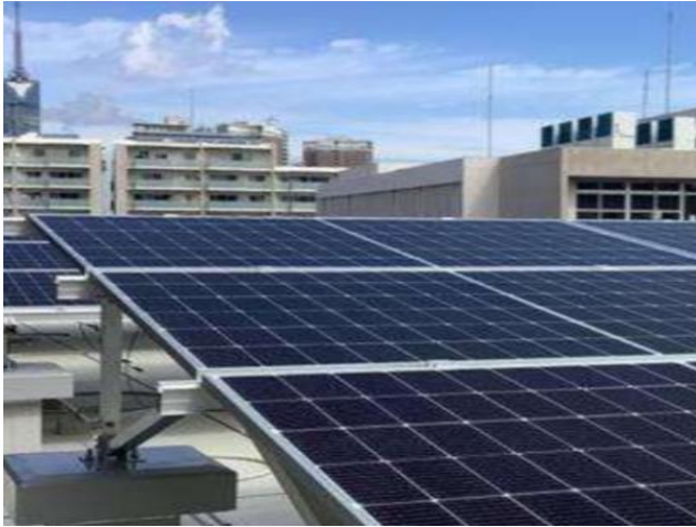
件名 西南学院大学様太陽光発電設備工事 概要 屋根上設置タイプ
