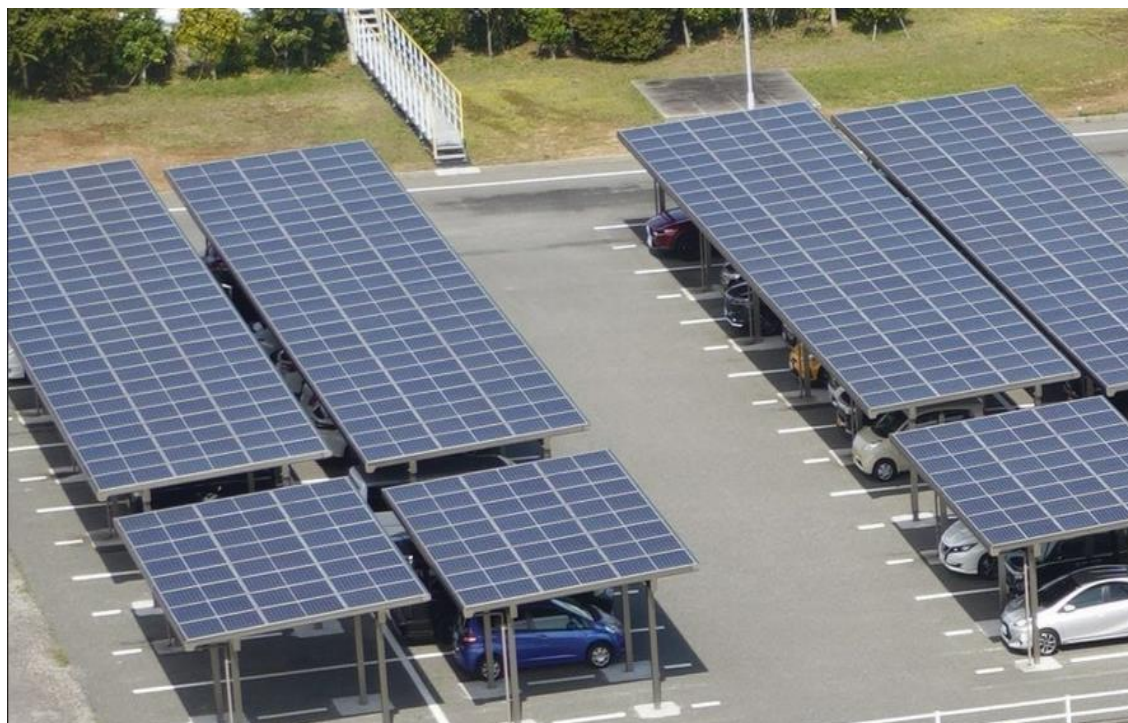
太陽光発電設備（カーポート一体型タイプ）
