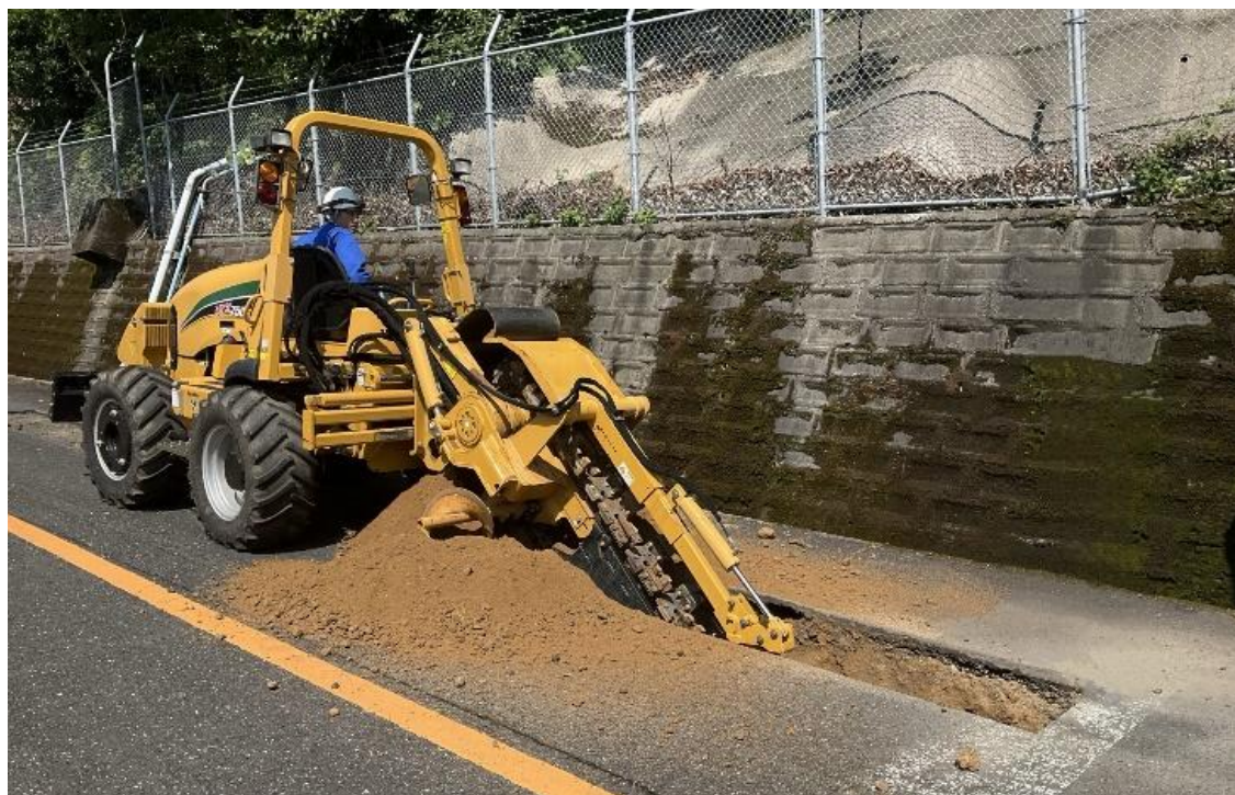
地中内中継伝送路設備
